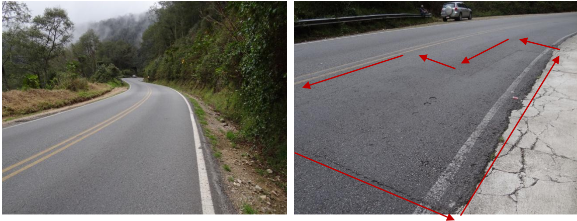
Fotografías 3 y 4. Superficie de rodamiento irregular, restándole seguridad a la vía
