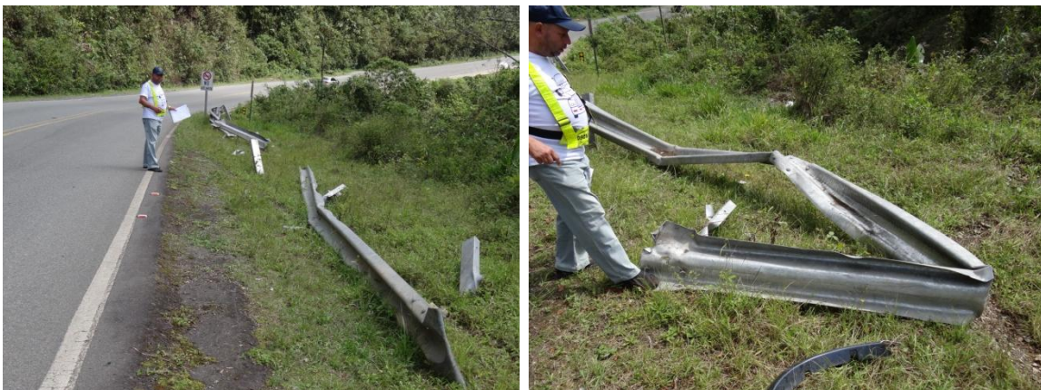
Fotografías 50 y 51. SCV impactados y destruidos sin su debida sustitución restándole seguridad al punto en caso de otro accidente por salida de la vía
