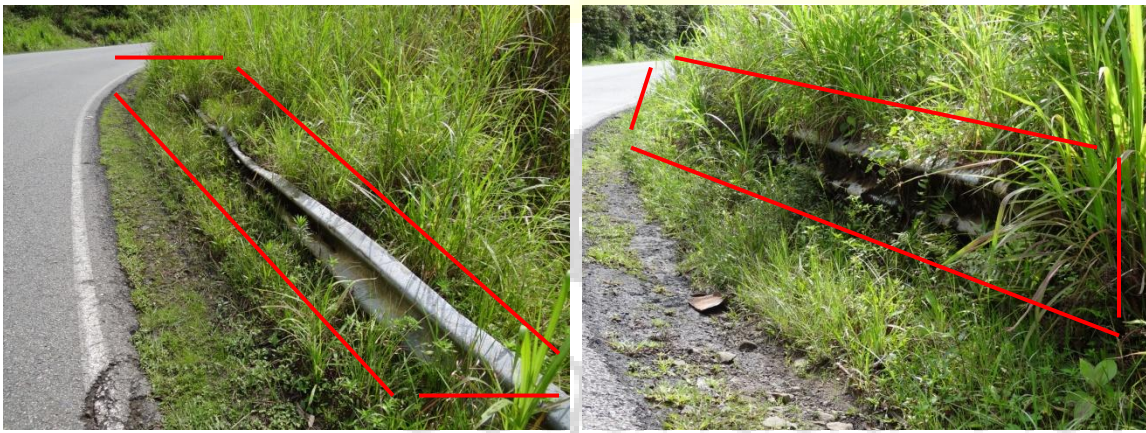
Fotografías 48 y 49. SCV bloqueados completamente por la vegetación, e impactados en ciertos tramos
