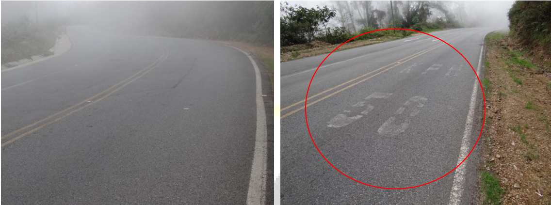
Fotografías 9 y 10. Demarcación horizontal desgastada, reduciendo la retroreflectividad de sus líneas
