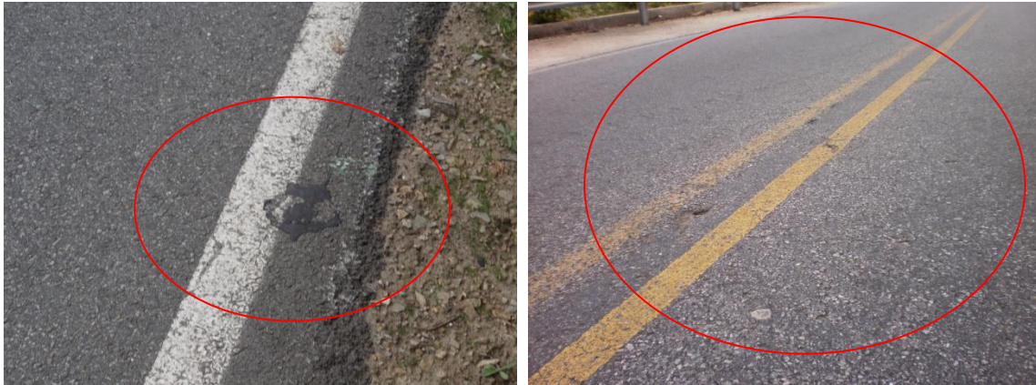
Fotografías 11, 12, 13 y 14. Desprendimiento y ausencia de captaluces en línea de borde y línea de centro
