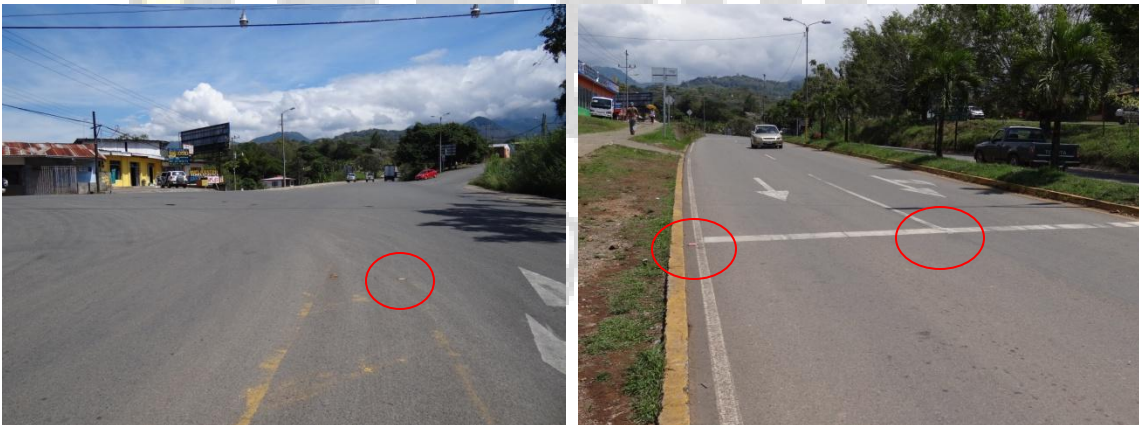
Fotografías 66 y 67. La inconsistencia de captaluces le resta seguridad a la vía especialmente en horario nocturno
