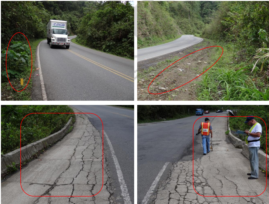
Fotografías 33, 34, 35 y 36. En este kilómetro no hay sistemas de drenaje, sólo en un sentido en la zona más peligrosa donde se concentran la mayor cantidad de accidentes del Km 120
