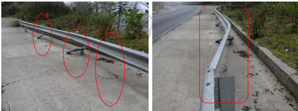
Fotografías 23 y 24. SCV impactado sin su debida sustitución
