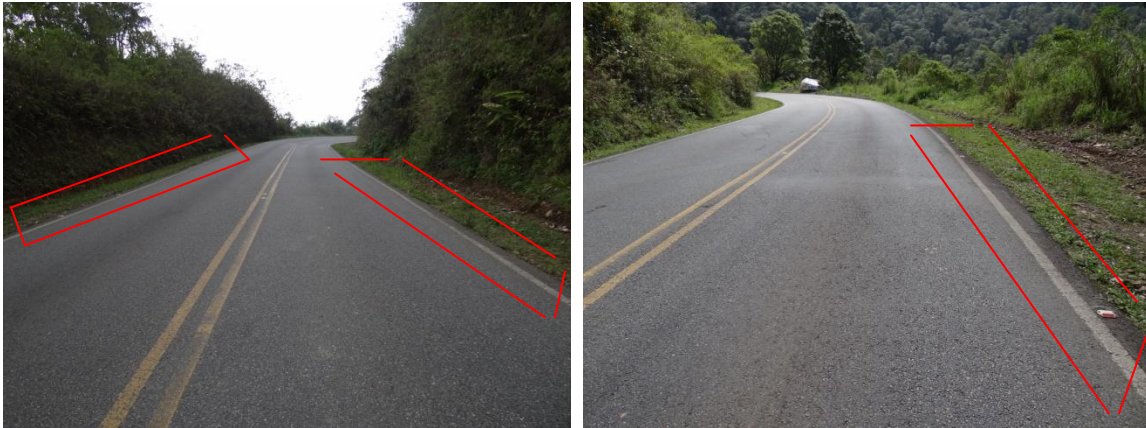
Fotografías 31 y 32. No hay hombros seguros a lo largo de la infraestructura vial
