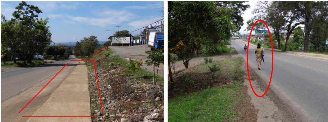
Fotografías 76 y 77. Inconsistencia en la acera peatonal
