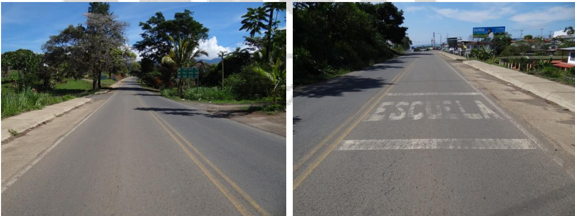
Fotografías 62 y 63. Deficiencias en las líneas de centro y de borde, debido al desgaste presente
