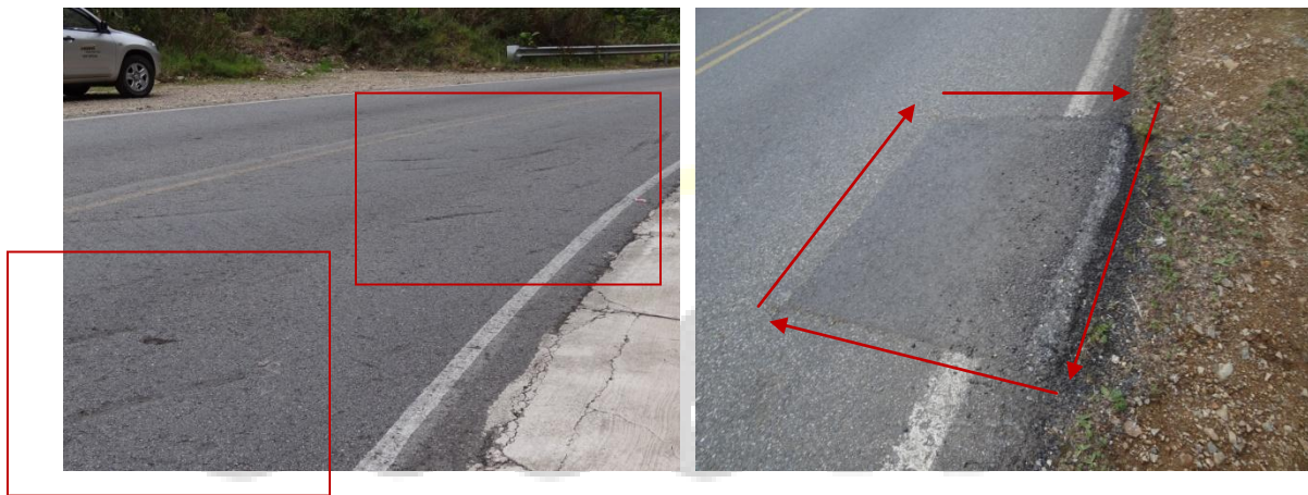
Fotografías 1 y 2. Ejemplos de fallas sobre la calzada
