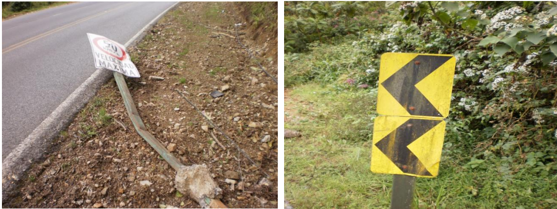
Fotografías 17 y 18. Ejemplo de la falta de mantenimiento al señalamiento vertical presente
