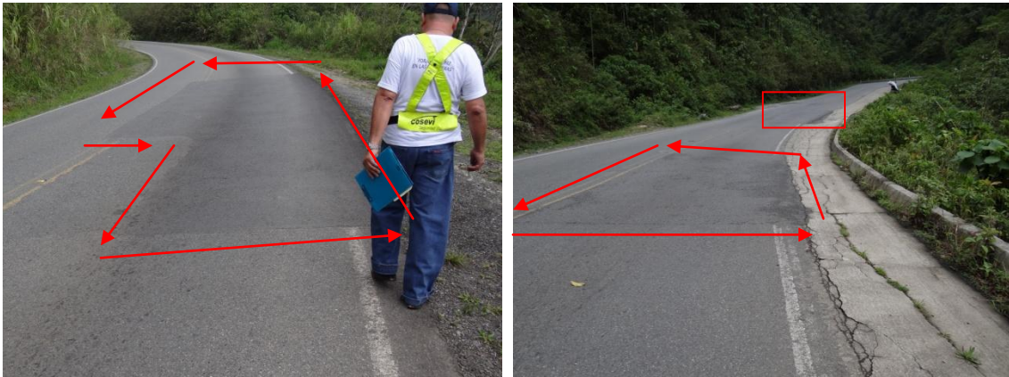
Fotografías 27 y 28. Superficie irregular en ciertos tramos de la calzada debido a trabajos de bacheo
