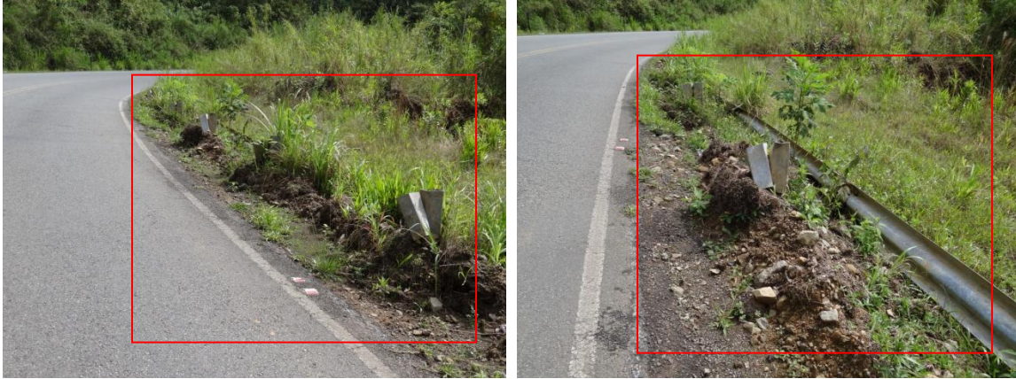
Fotografías 46 y 47. Barreras de seguridad inhabilitadas completamente
