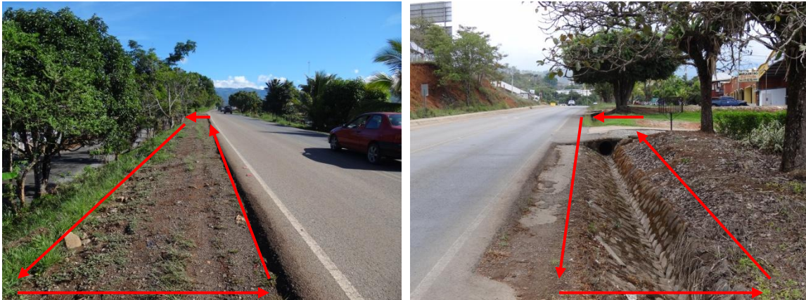
Fotografías 60 y 61. Inconsistencia en los sistemas de drenaje
