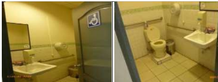
Fotografías 17-18. La puerta del baño para personas con discapacidad debería abrir hacia afuera.
