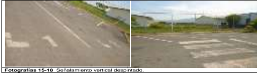
Fotografías 15-18 Señalamiento vertical desvirtuado.
