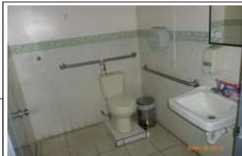
Fotografía 19. No existe rotulación que informe de la existencia de un servicio sanitario para personas con discapacidad.
