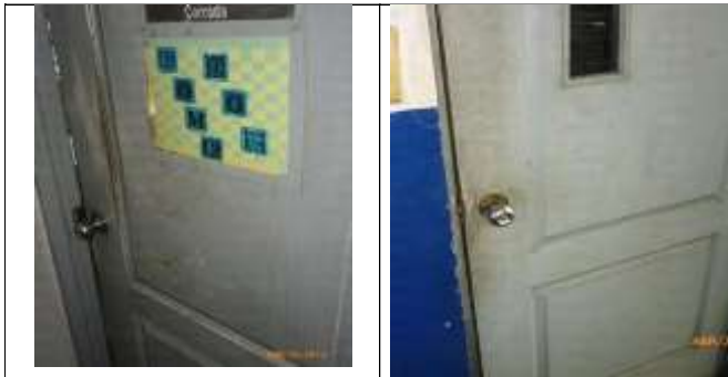
Fotografías 29-30 Puertas despintadas.
