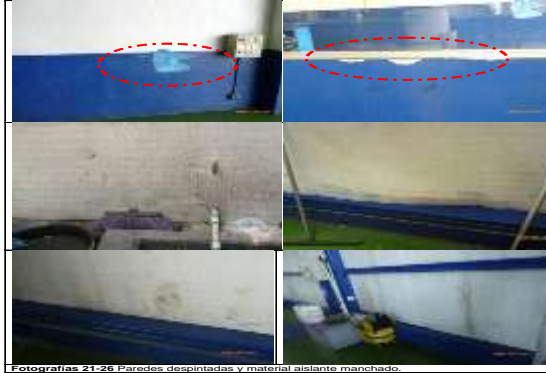
Fotografías 21-26 Paredes desvirtuadas y material aislante manchado.
