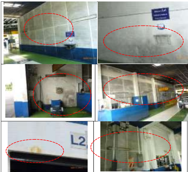
Fotografías 1-6 Hay paredes manchadas en líneas de inspección (paredes y láminas de "jordomex" (líneas 3 y 4)).
